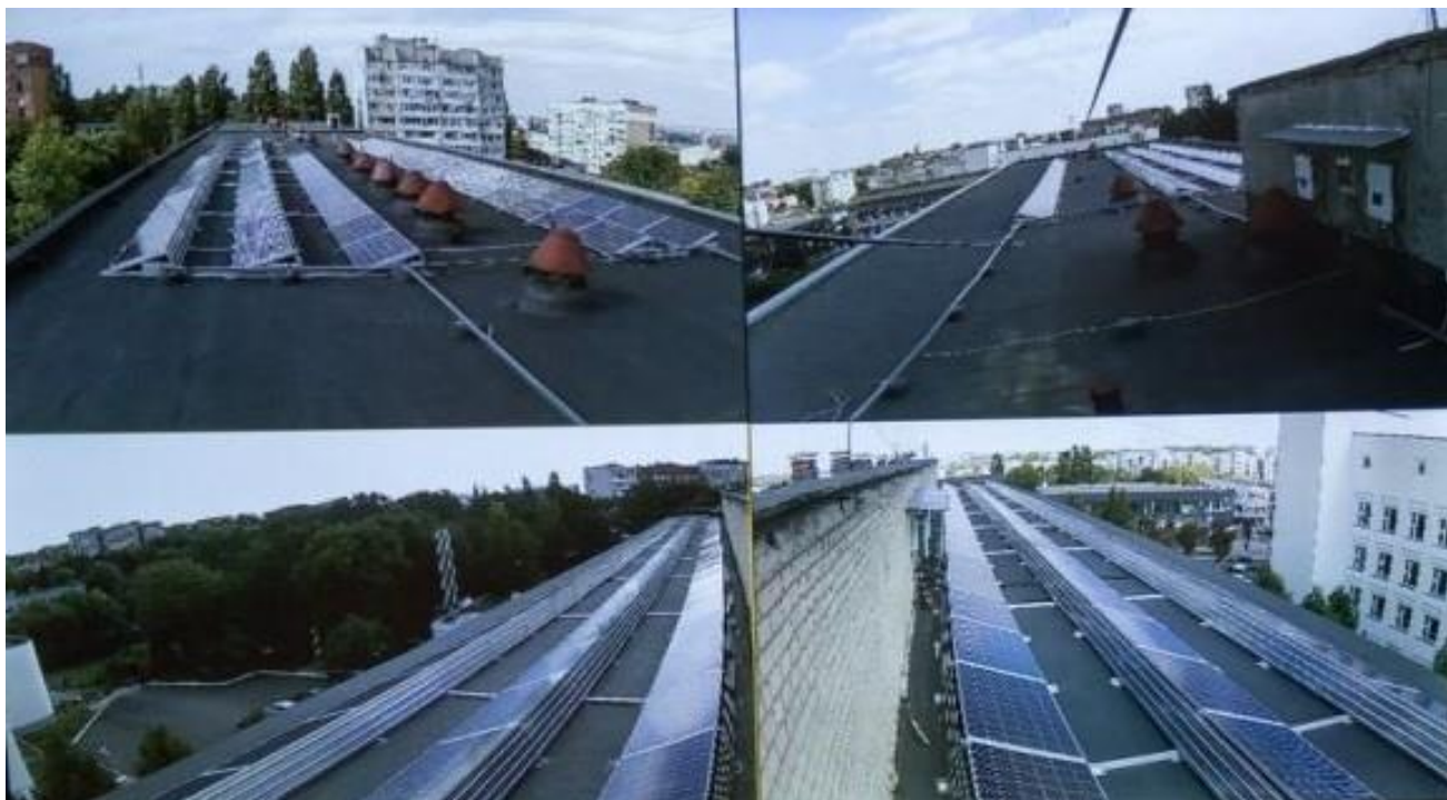
Рисунок 8 – Дахова сонячна електростанція
